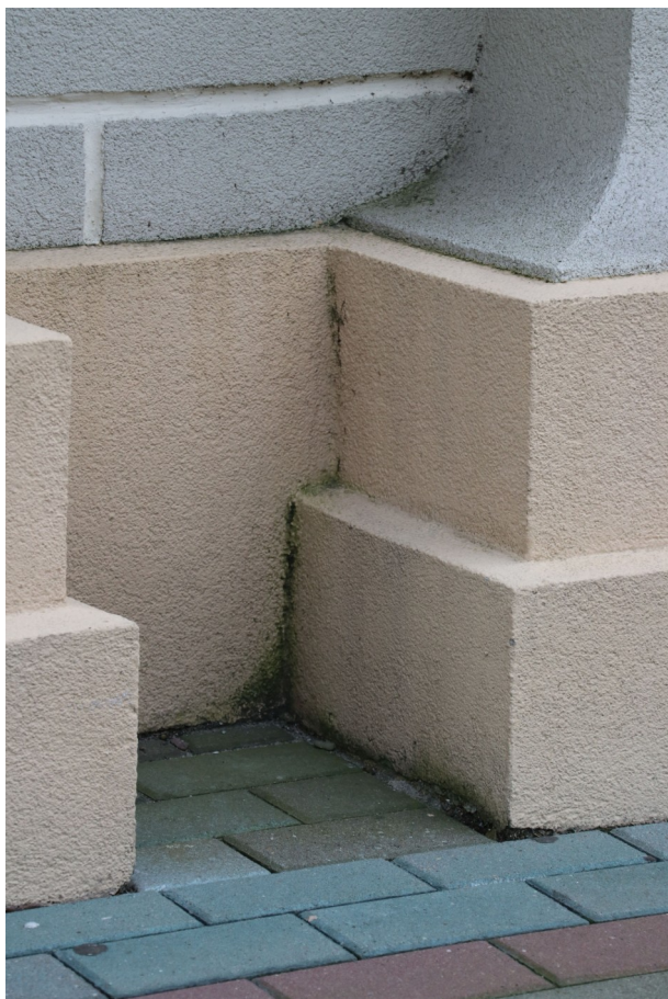
fot. 15: Elewacja frontowa - nalot biologiczny w obrębie cokołu bazy pilastra oraz naciek z patyny miedzianej na kostce brukowej.
