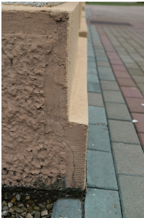
fot. 53: Elewacja południowa - widoczne spękania zacierki cementowej cokołu oraz nalot z patyny miedzianej na kostce brukowej.
