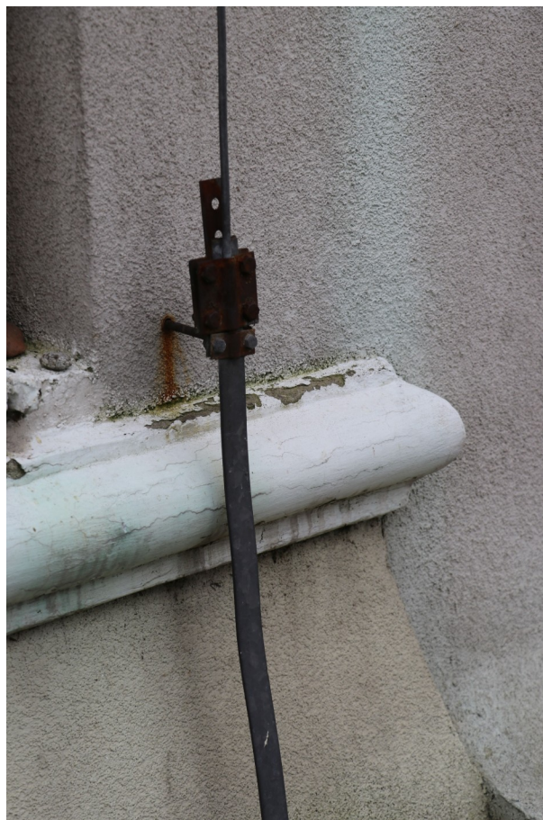
fot. 50: Elewacja południowa - korozja złącza instalacji odgromowej.
