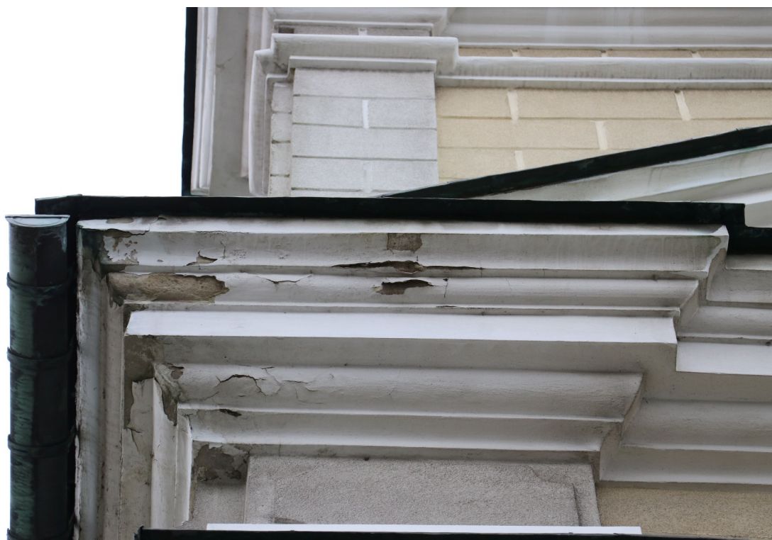
fot. 3: Elewacja frontowa - zdegradowany gzyms wieńczący kondygnacji parteru po lewej stronie elewacji.
