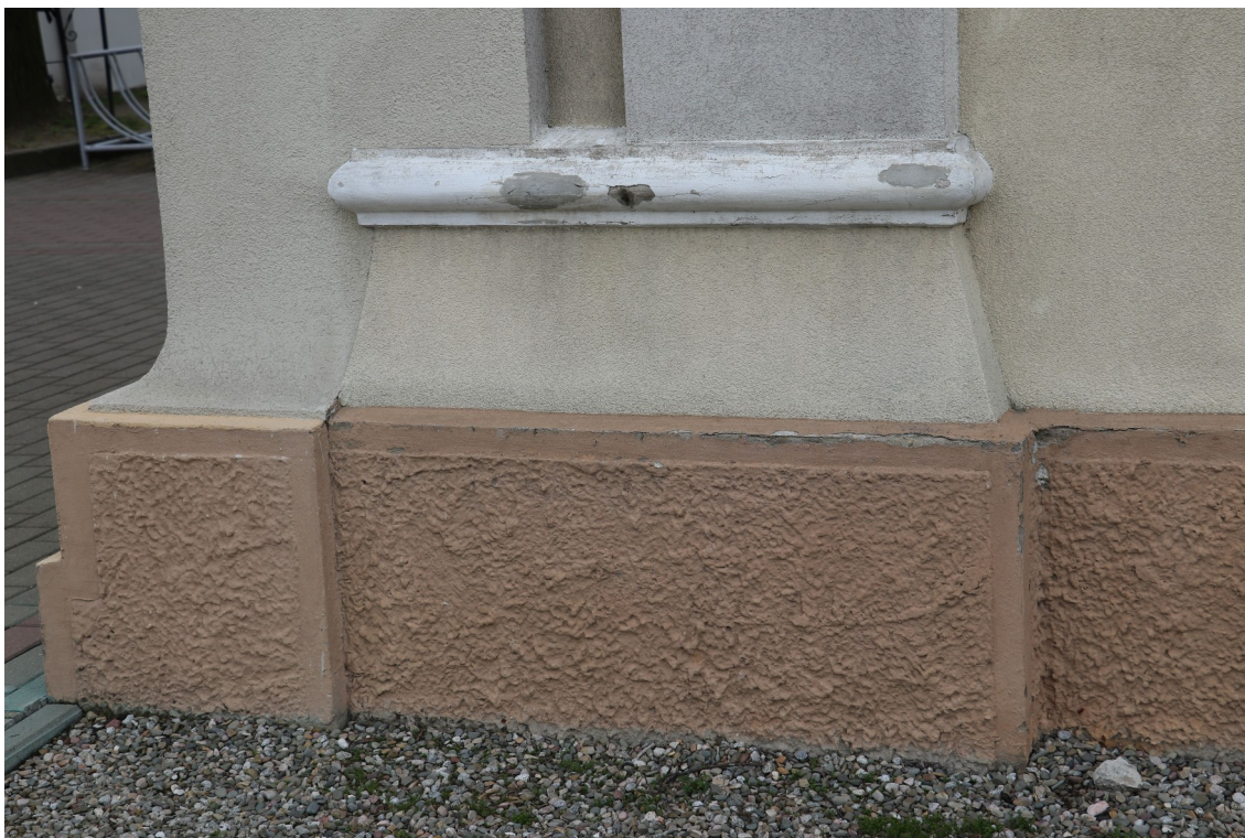
fot. 18: Elewacja południowa - cokół pokryty cementowym nakropem o strukturze baranka.
