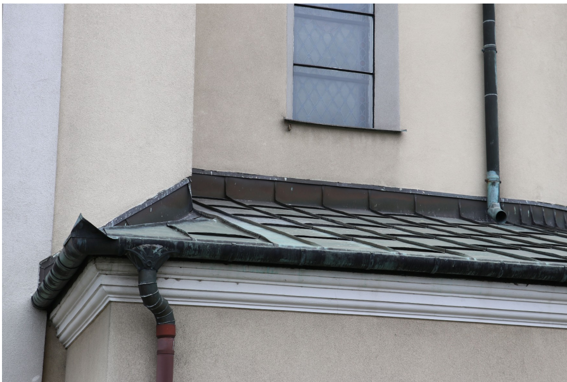
fot. 26: Elewacja południowa - fragment rynny i rury spustowej dachu zakrystii.
