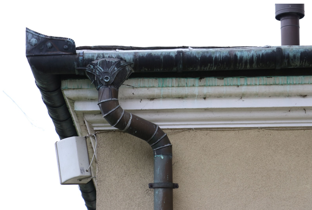
fot. 44: Elewacja południowa - widoczny oryginalny lej spustowy oraz zacieki z patyny miedzianej na gzymsie elewacji zakrystii.
