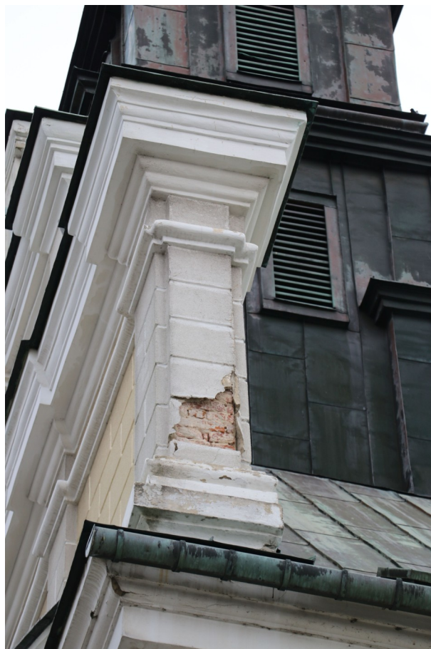
fot. 16: Elewacja frontowa - ubytek tynku elewacyjnego w obrębie szczytu elewacji.
