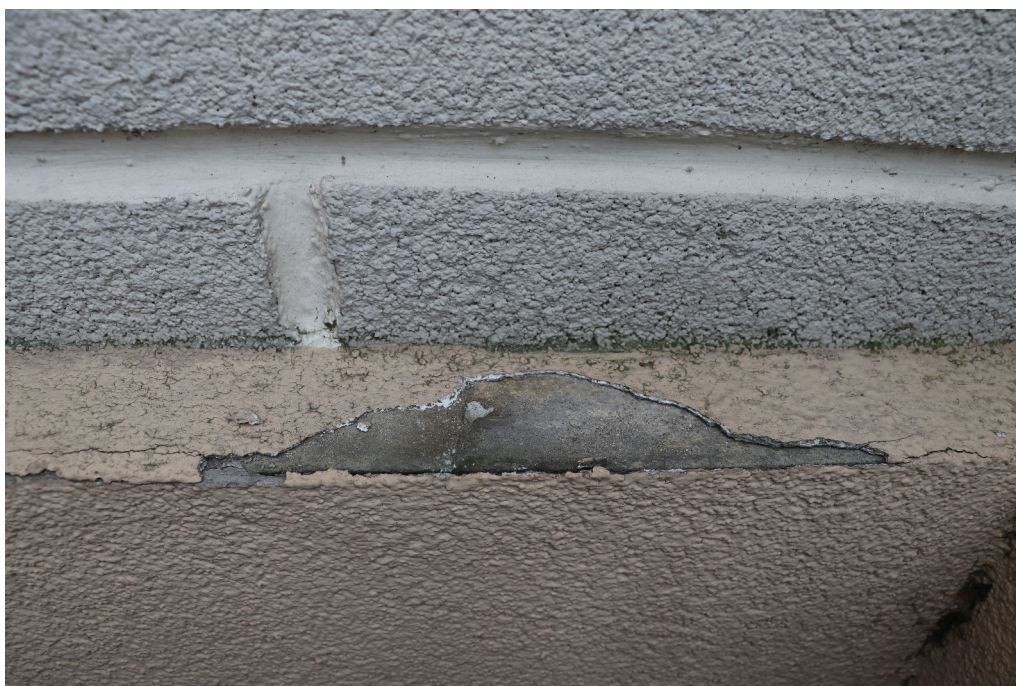
fot. 17: Elewacja frontowa - ubytek zacierki cementowej odsłaniający warstwę pierwotną elewacji.
