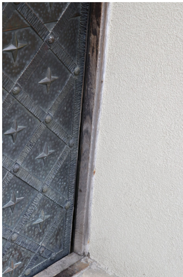
fot. 7: Elewacja frontowa - nieszczelność w obrębie drzwi wejściowych do kościoła widoczna od zewnątrz.
