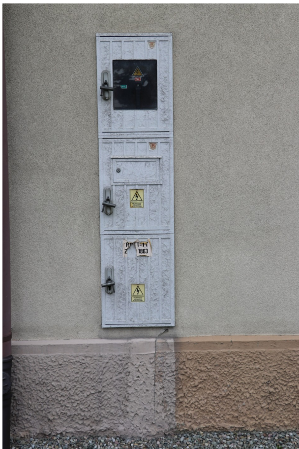
fot. 42: Skrzynki instalacyjne prądowe na elewacji zakrystii.
