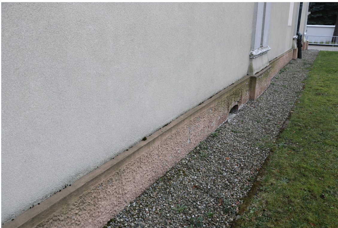
fot. 46: Elewacja południowa - nalot biologiczny na cokole elewacji.
