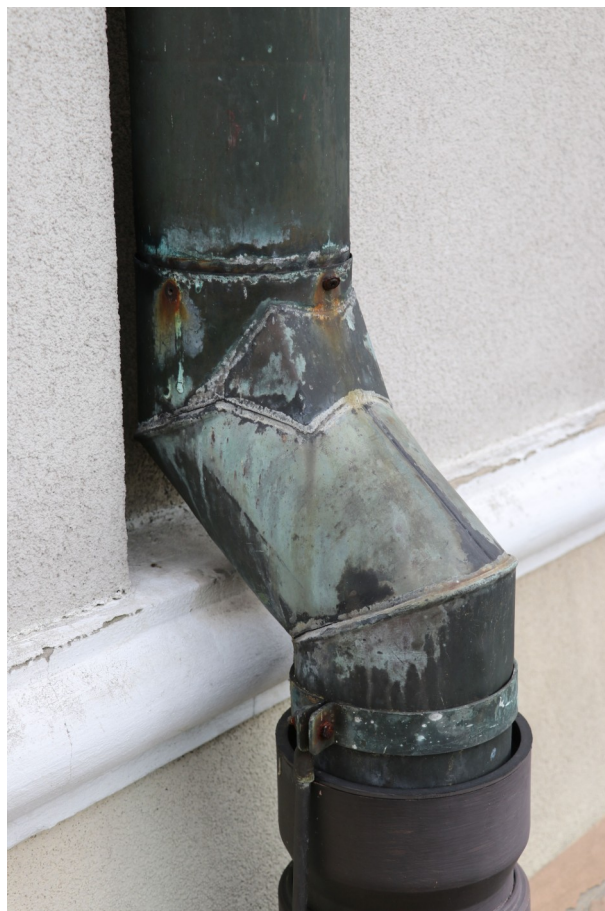
fot. 23: Elewacja południowa - skorodowane śruby mocujące elementy rury spustowej.
