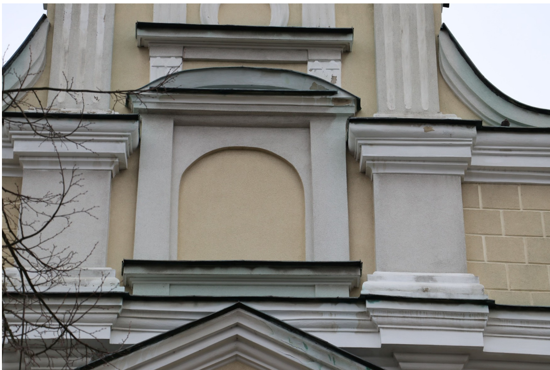
fot. 2: Elewacja frontowa - fragment górnych kondygnacji z widocznymi ubytkami tynku.
