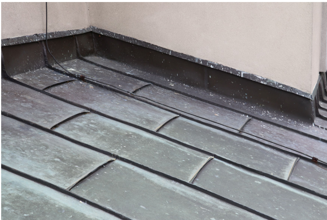
fot. 38: Elewacja tylna - instalacja odgromowa poprowadzona po dachu zakrystii.
