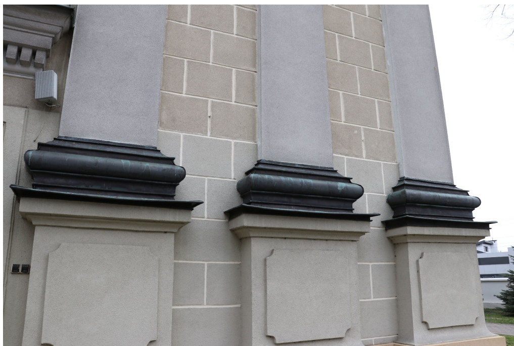
fot. 14: Elewacja frontowa - obróbka blacharska profilowania baz pilastrów. Widoczne odkształcenia arkuszy blachy.
