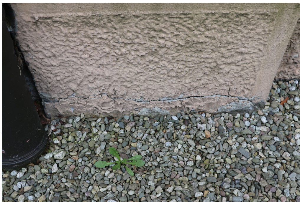
fot. 54: Elewacja południowa - uszkodzenie tynku cokołowej przy linii gruntu.
