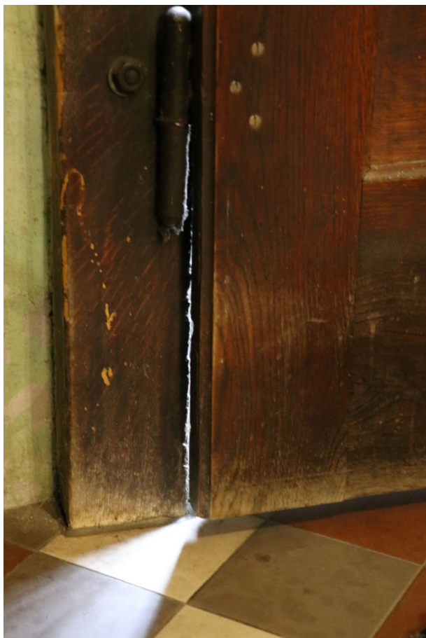
fot. 12: Widoczna nieszczelność drzwi wejściowych widoczne od wewnątrz.
