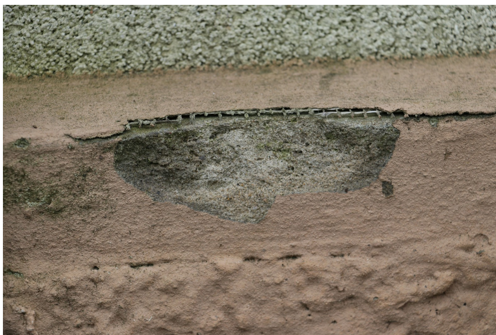
fot. 51: Elewacja południowa - ubytek zacierki cementowej parapetu cokołu ujawniający obecność siatki budowlanej.
