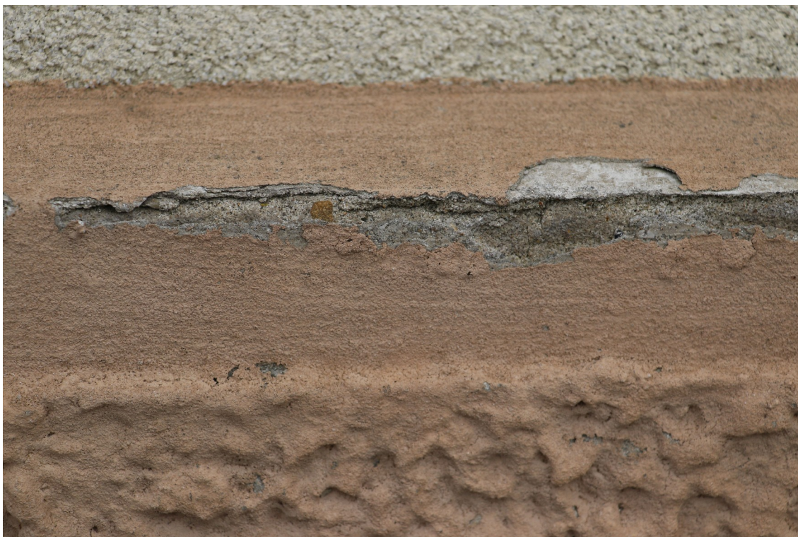
fot. 19: Elewacja południowa - widoczny ubytek cementowej zacierki na płaszczyźnie parapetu cokołu.
