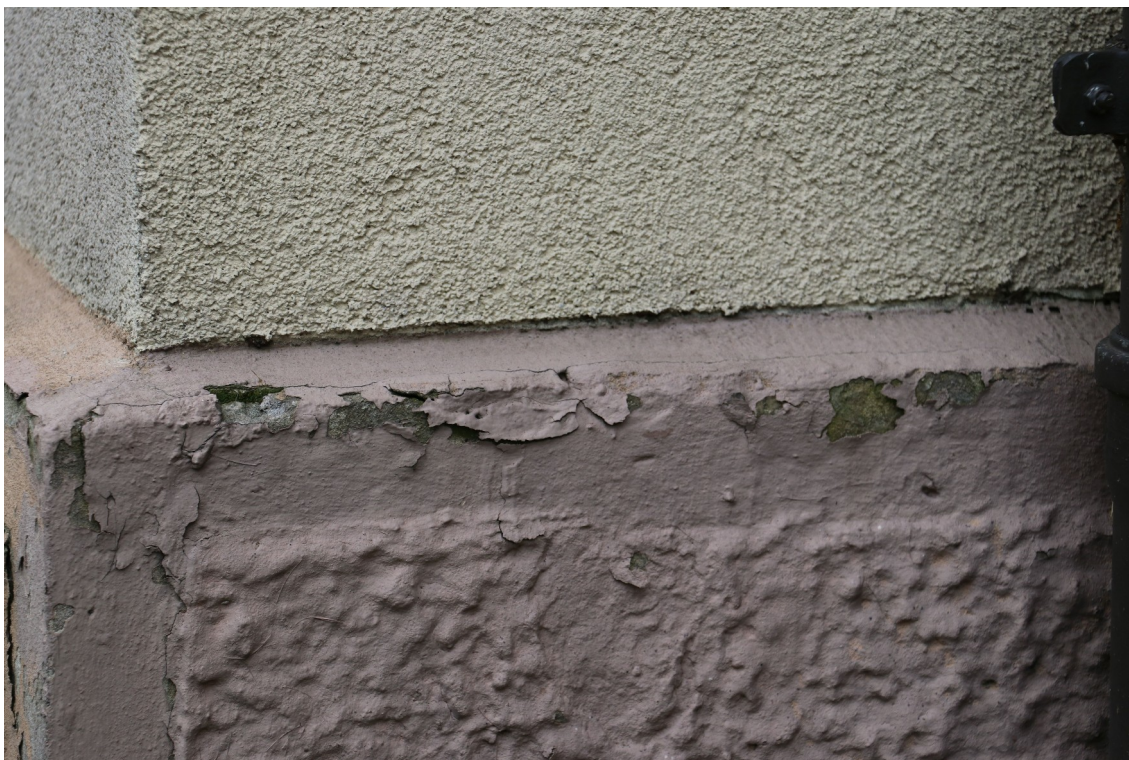
fot. 45: Elewacja południowa - złuszczenia zacierki i farby wierzchniej na cokole zakrystii.
