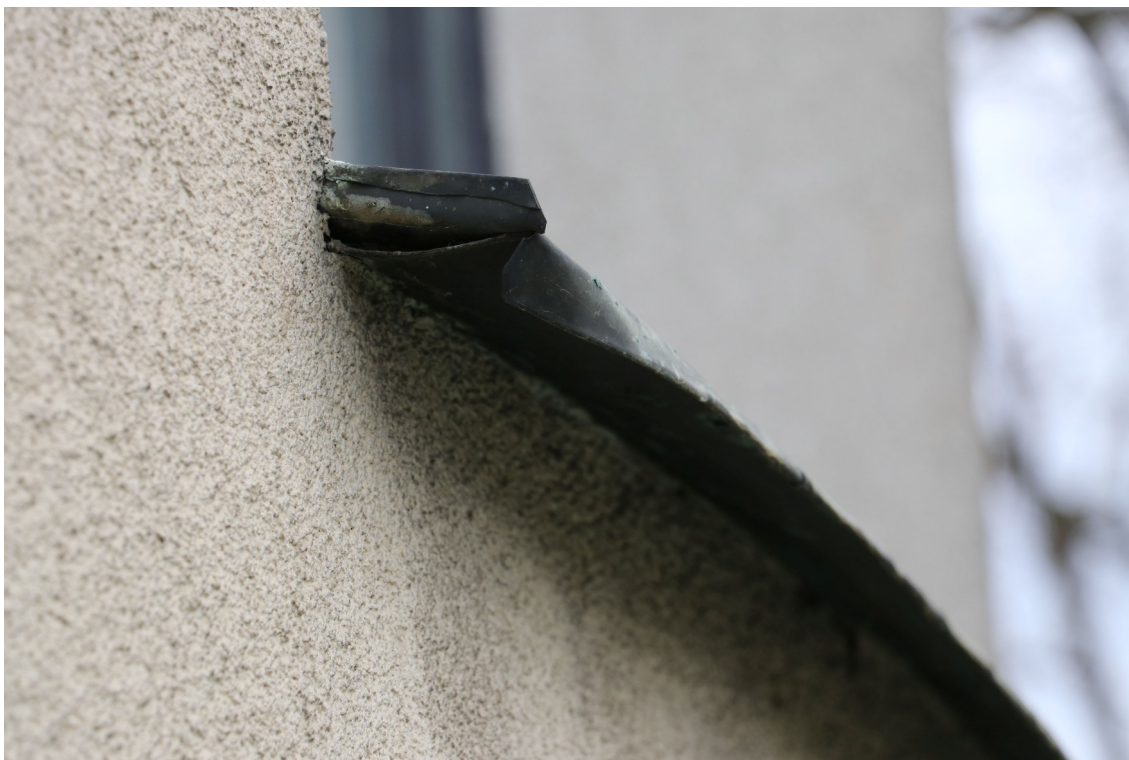
fot. 39: Elewacja tylna - odkształcenie parapetu okiennego, powodujące zacieki na elewacji.
