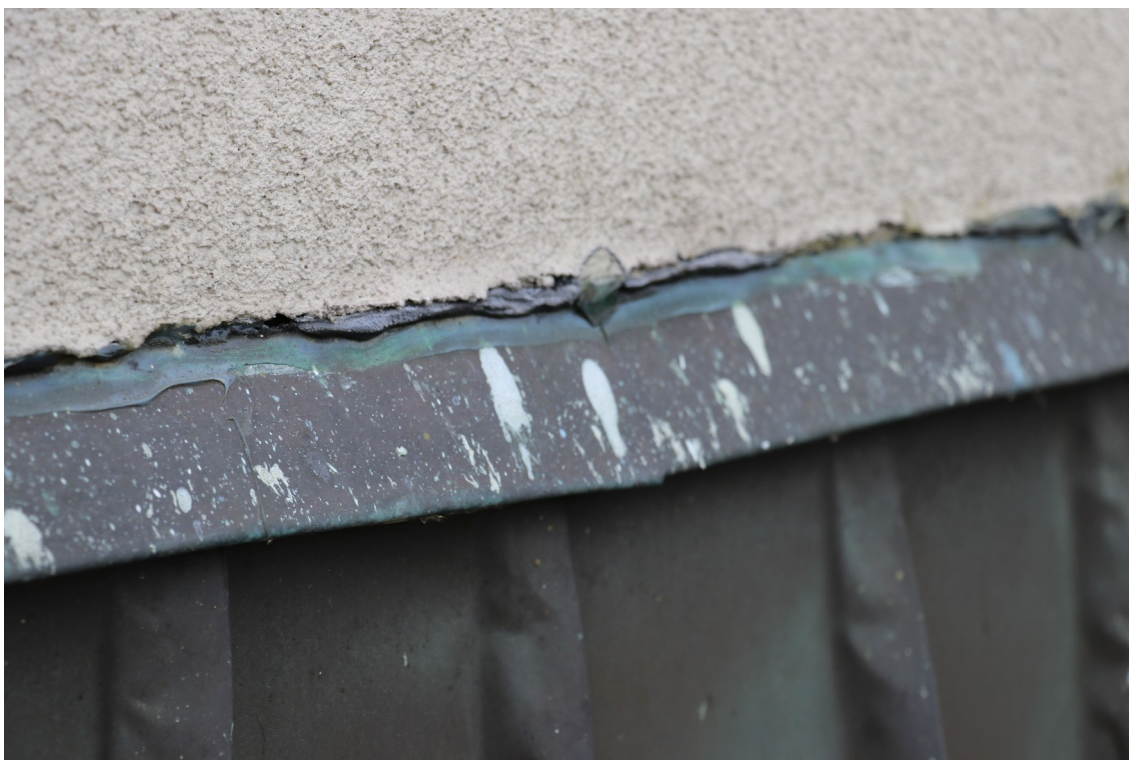
fot. 37: Elewacja tylna – zdegradowany kit dekarSKI uszczelniający połączenie obróbki blacharskiej z tynkiem.
