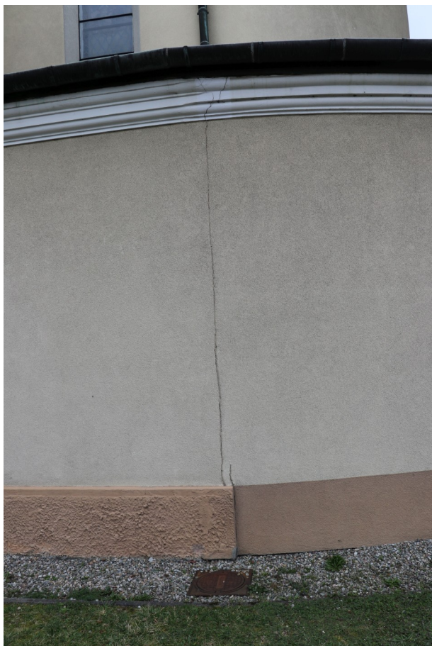
fol. 31: Elewacja południowa - dylatacja w obrębie zakrystii.
