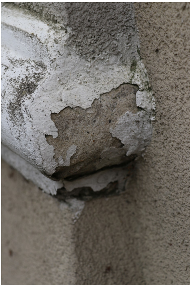
fot. 49: Elewacja południowa - ubytek zacierki cementowej odsłaniający starszy tynk profilu bazy pilastra.
