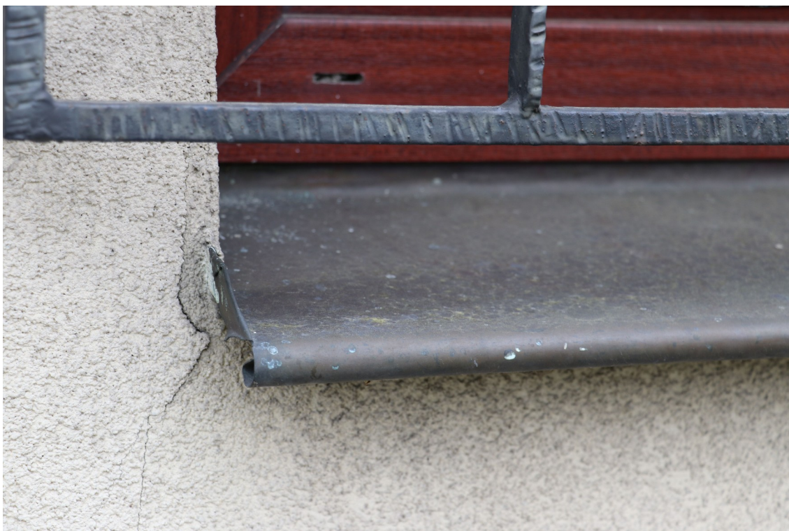
fot. 27: Elewacja południowa - pęknięcie tynku elewacyjnego w obrębie parapetu okna zakrystii.
