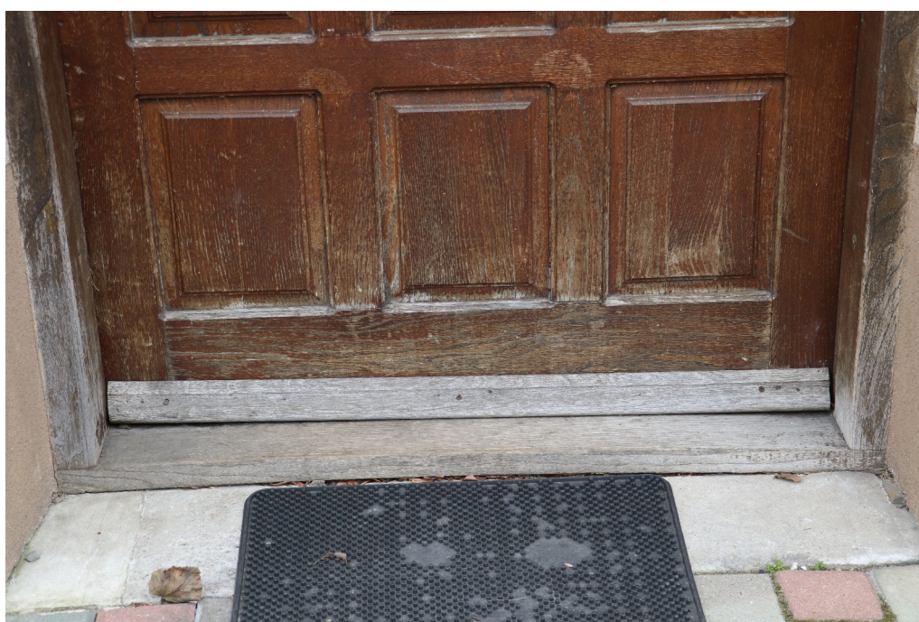
fot. 57: Widoczna degradacja powłoki wierzchniej drzwi wejściowych powodujące szarzenie drewna.
