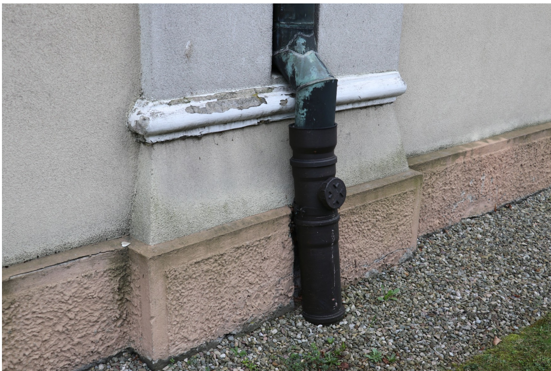
fot. 47: Elewacja południowa - nalot biologiczny partii cokołowej pokrytej nakropem cementowym o strukturze baranka oraz ubytek zacierki na profilu bazy pilastra.
