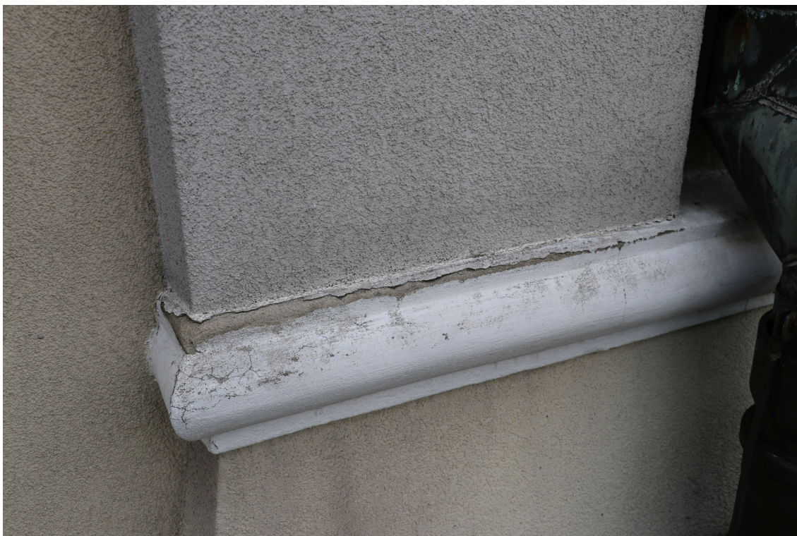
fot. 21: Elewacja południowa - ubytek zacierki cementowej na profilu bazy pilastra.
