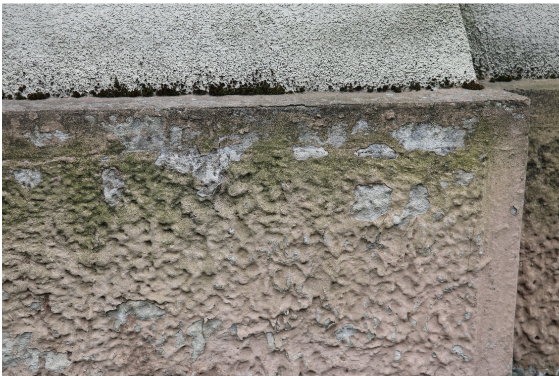
fot. 48: Elewacja południowa - ubytki zacierki cementowej na cokole.
