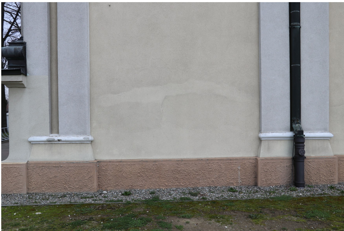
fot. 20: Elewacja południowa - widoczne rozległe odspojenie wierzchniej warstwy tynku elewacyjnego.
