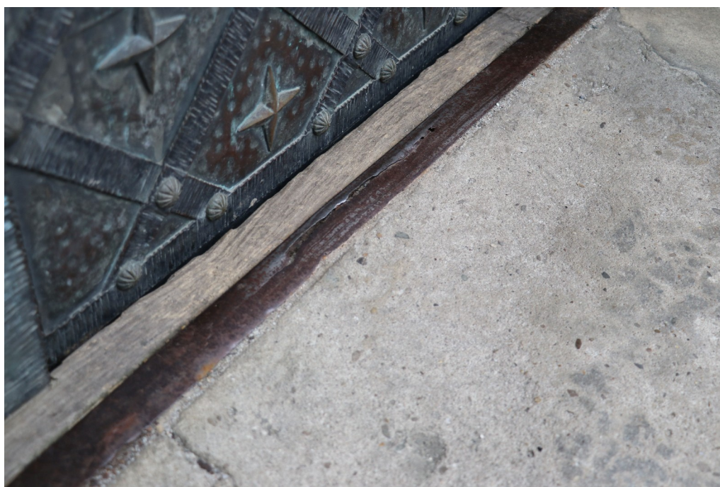
fot. 8: Elewacja frontowa - wytarty drewniany próg drzwi wejściowych oraz metalowa osłona progu.
