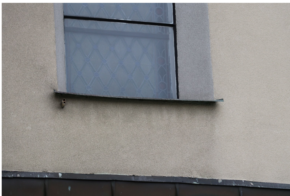
fot. 30: Elewacja południowa - zabrudzenia atmosferyczne pod parapetem otworu okiennego.
