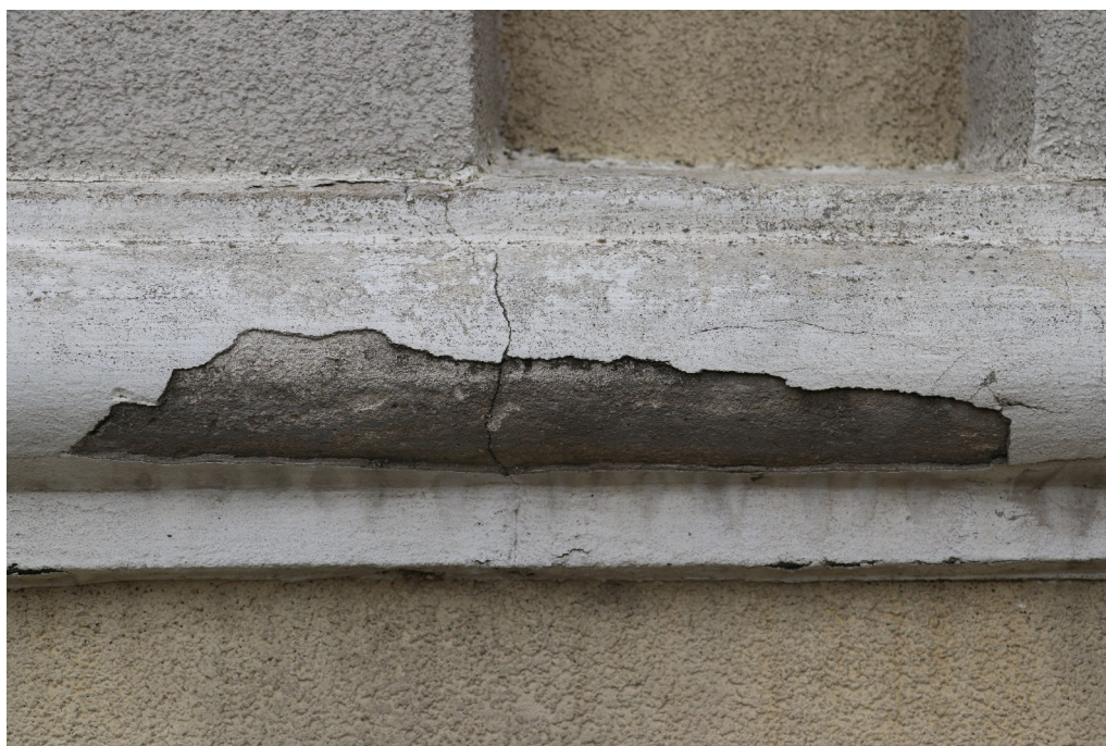
fot. 24: Elewacja południowa - ubytek zacierki cementowej na profilu bazy pilastra.
