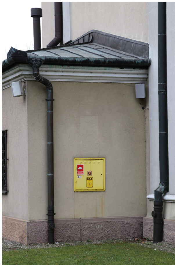
fot. 43: Skrzynka gazowa na elewacji zakrystii - widoczna korozja oraz zacieki z rdzy na elewacji.
