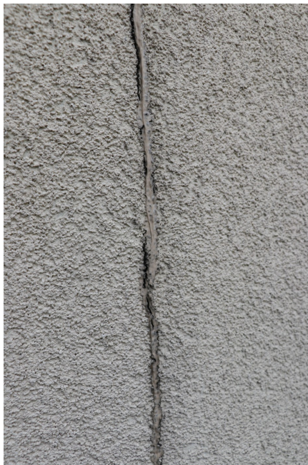
fol. 32: Elewacja południowa - widoczne nieszczelności dylatacji.
